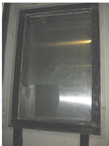
Fenêtre de mesures côté réception
